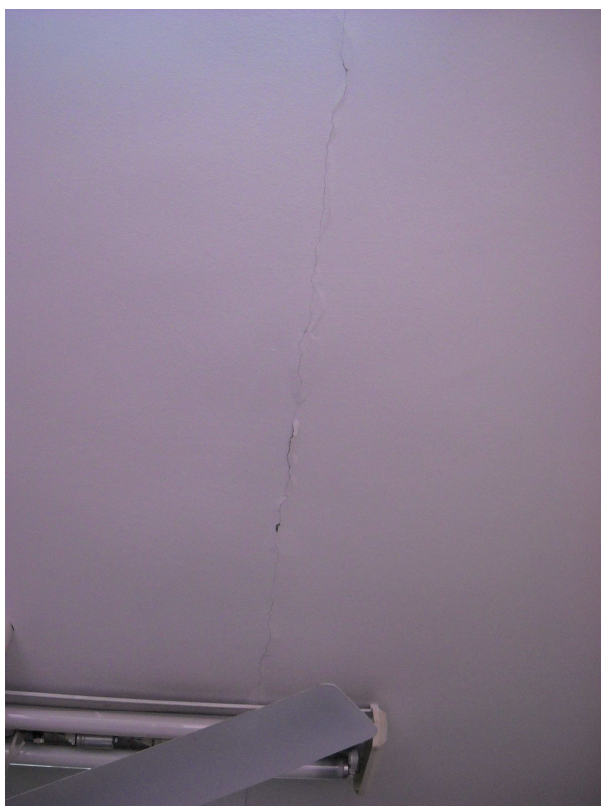
Fot. 15. Istniejące pęknięcia tynku na stropie do naprawy
