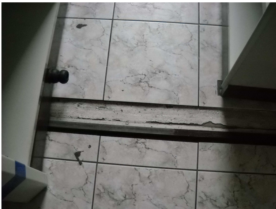
Fot. 11. Istniejące szyny jezdne pod regały przesuwne zamontowane w podłodze pom. nr 8.
