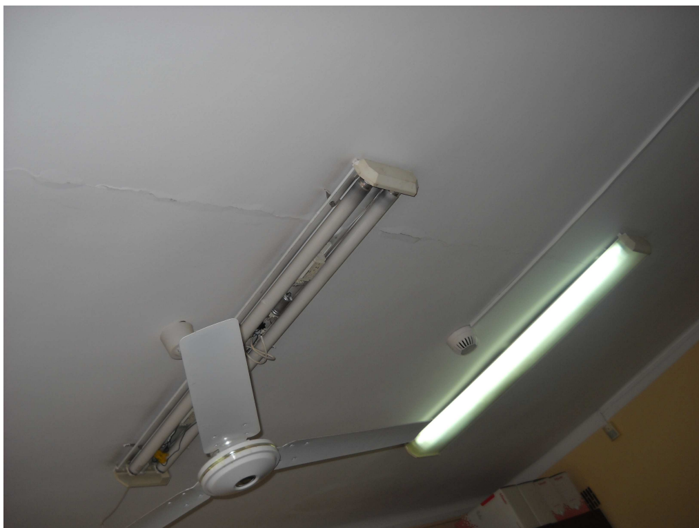
Fot. 14. Istniejące instalacje do demontażu i wymiany na nowe, pęknięcia tynku w stropie.
