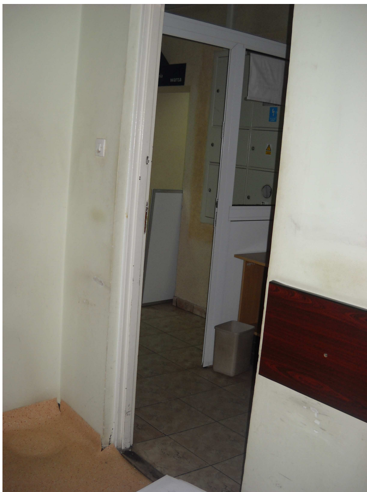
Fot. 6. Drzwi do pom. socjalnego do zamurowania
