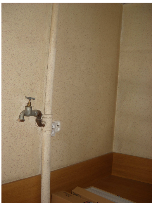
Fot. 7. Istniejący pion od hydrantu w pom. socjalnym nr 5
